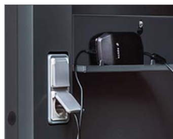
Steckdosen und Ablageschale.
