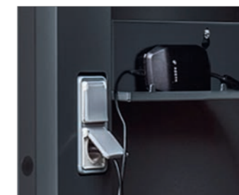
Steckdosen und Ablageschale.
